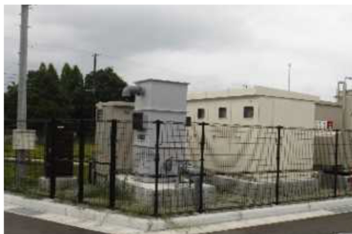
非常用発電機 27
