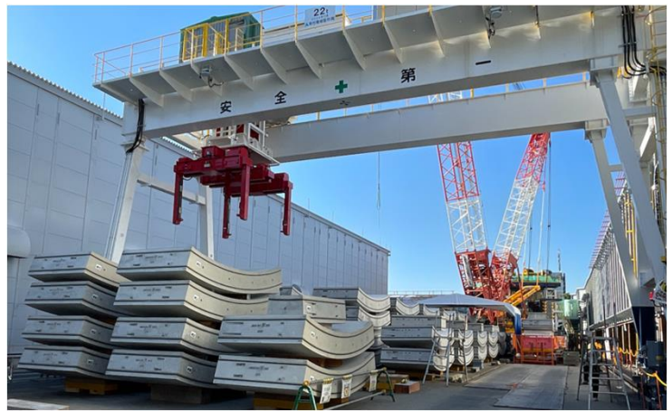
写真-4 地上自動橋形クレーン
