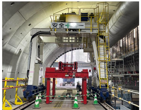
写真-5 坑内自動橋形クレーン
