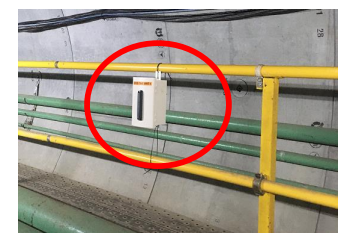
写真-3 RFIDタグの坑内設置例
