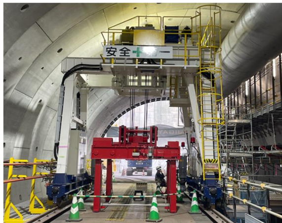
写真-5 坑内自動橋形クレーン
