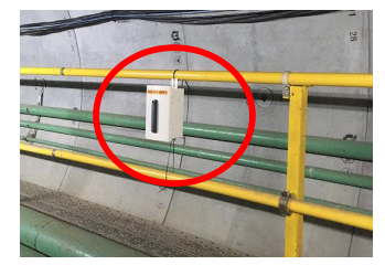
写真-3 RFIDタグの坑内設置例
