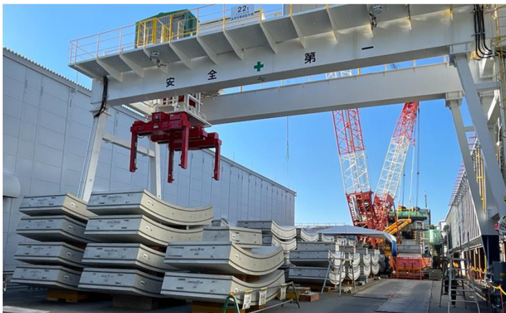
写真-4 地上自動橋形クレーン
