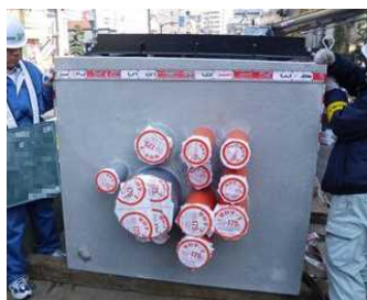
電力と通信の特殊部を共有化
