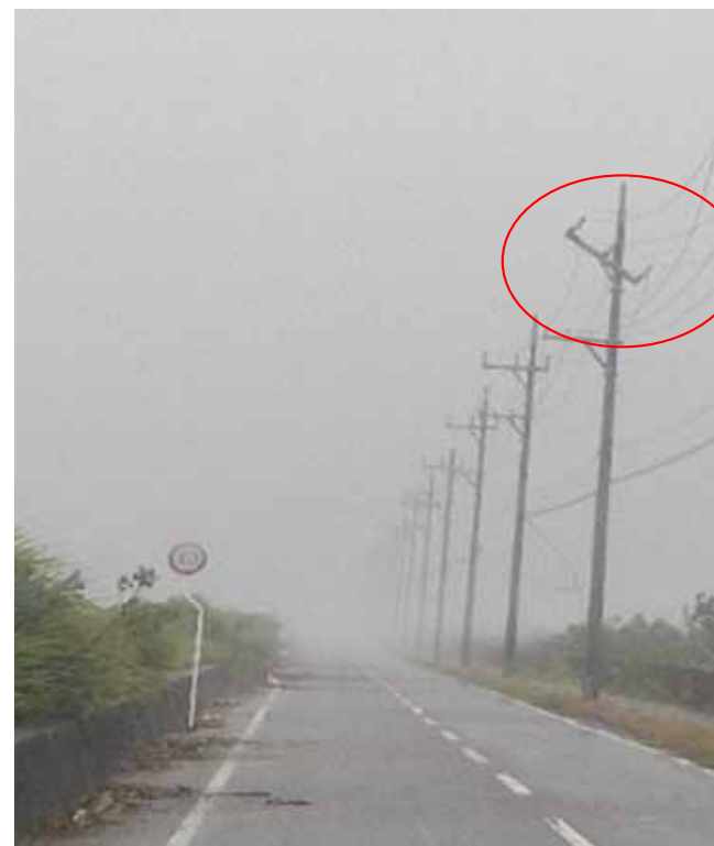
<暴風による電柱被害>
