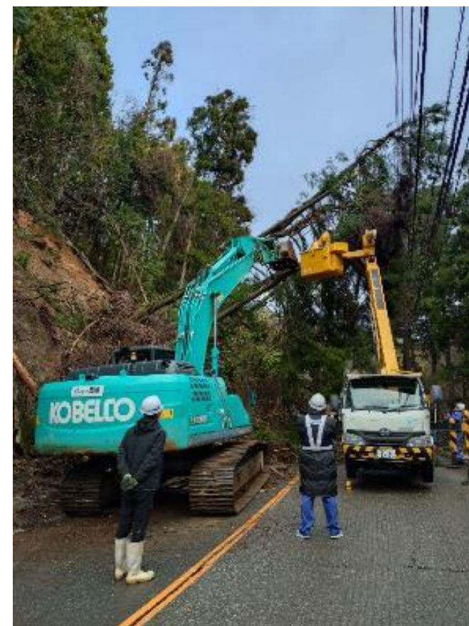
石川県穴水町 県道303号
