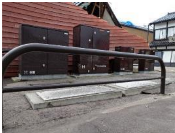
地上機器周辺での段差や路面ひび割れは複数確認
