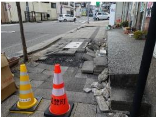
特殊部が浮き上がり歩道の規制をしている箇所
