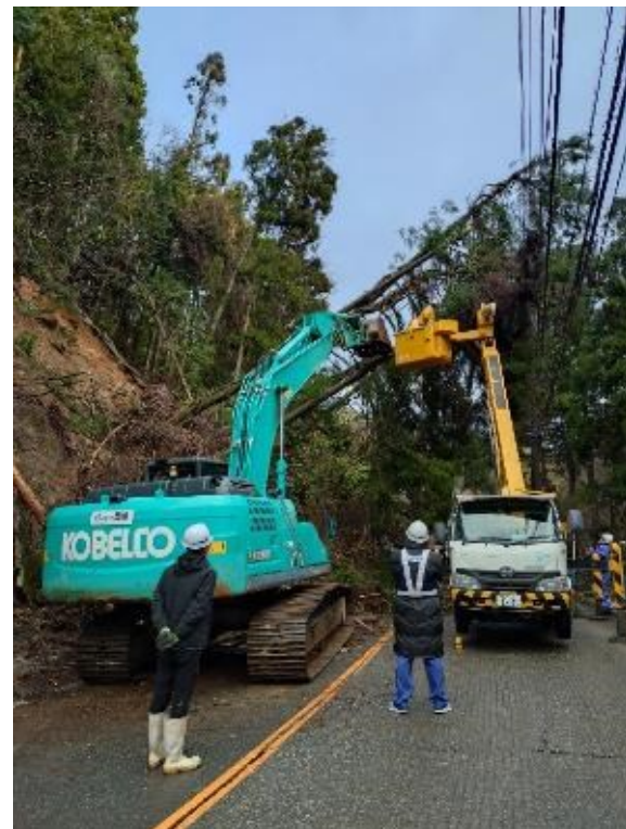
石川県穴水町 県道303号
