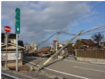
【令和6年1月 能登半島地震による電柱倒壊状況】 (石川県輪島市)
