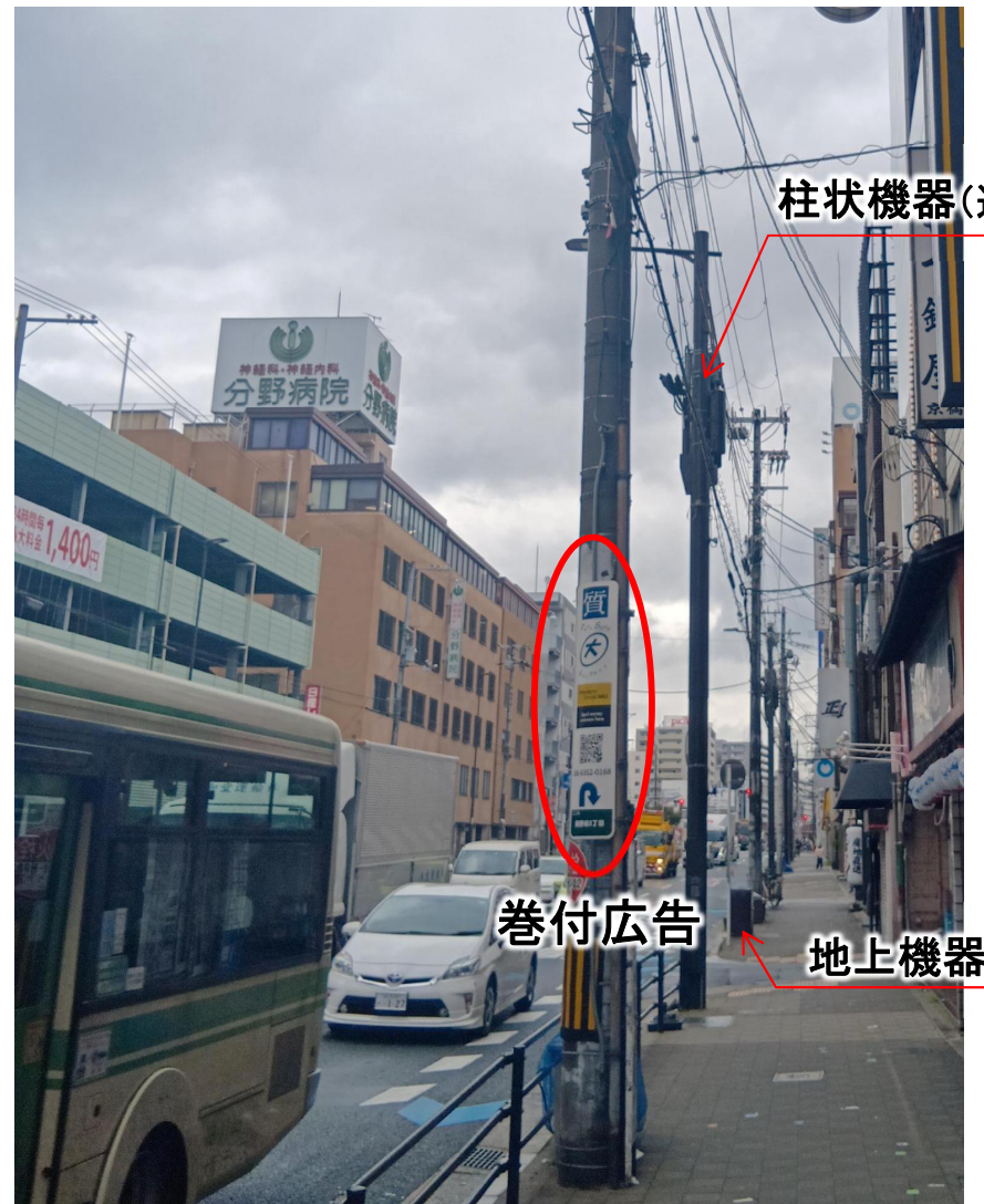
【電柱撤去が大幅に遅れている区間における広告の２次占用の様子】
