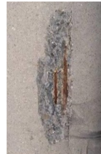
コンクリートの剥離・内部鉄筋の錆
