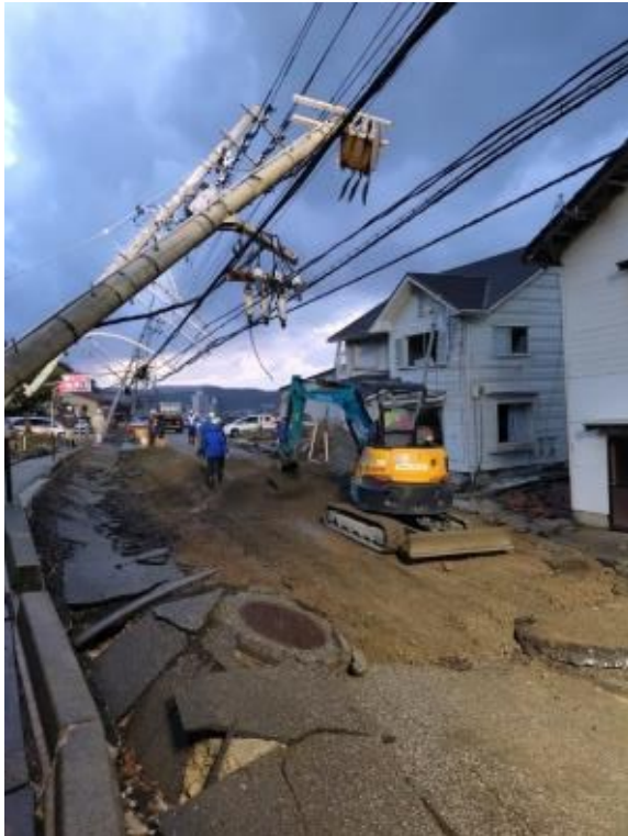
石川県輪島市 国道249号
