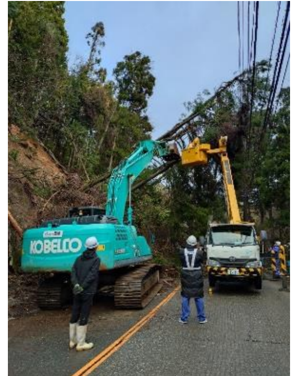
石川県穴水町 県道303号
