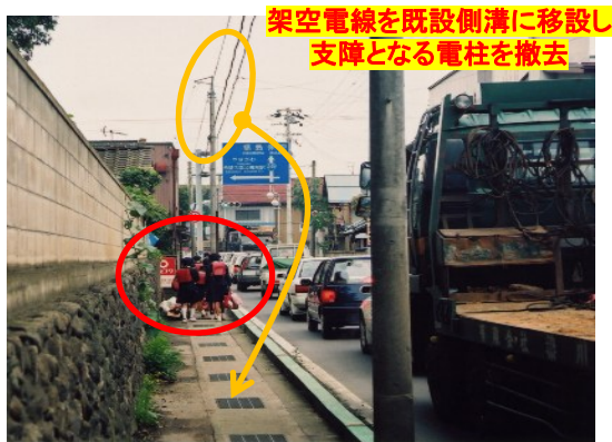
電柱により車道へはみ出す恐れがある歩道
