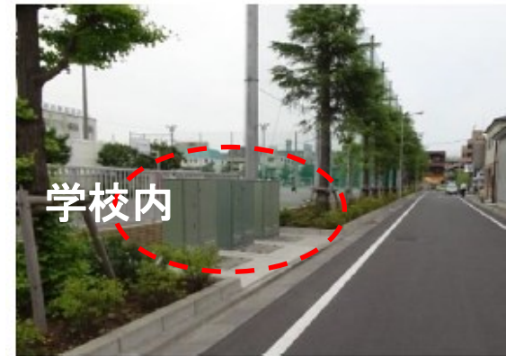
【学校敷地を活用して地上機器を設置した事例】
