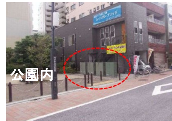
【公園敷地を活用して地上機器を設置した事例】
