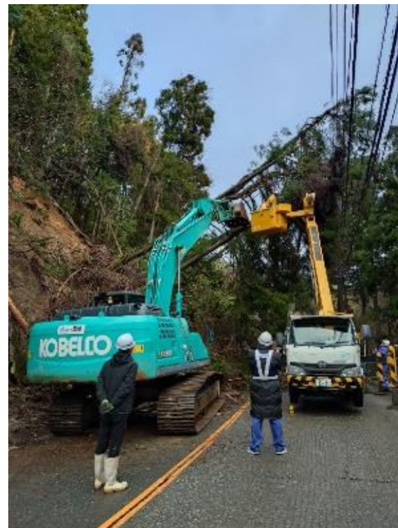
石川県穴水町 県道303号
