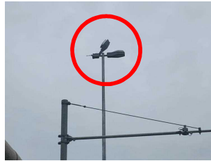
国道25号における 照明灯具破損・落下事故
