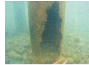
▲橋脚水中部の断面欠損
