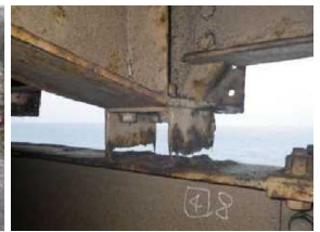
▲シェッド主梁端部破断
