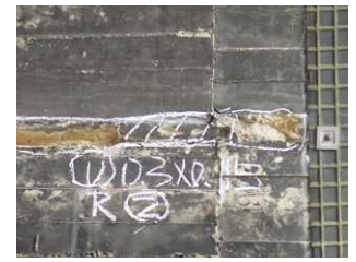
(写真)はく落跡
