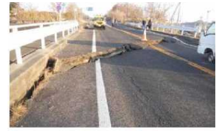
橋台背面の沈下により生じた段差により車両の通行が困難になった事例
