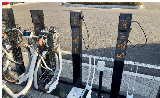
シェアサイクルの充電サイクルポート 出典: OpenStreet株式会社
