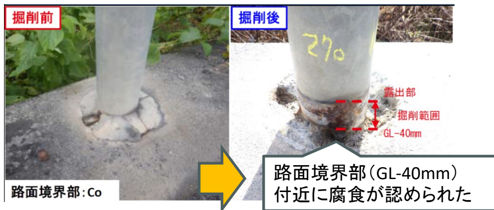
基部を掘削して初めて 腐食有無が判明する場合がある
