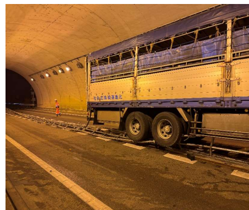
区画柵損傷状況 （損傷延長 L=50m）
