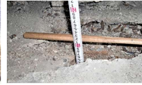
中床版上面のコンクリート剥離
