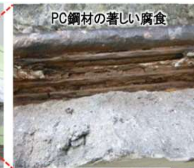
PC鋼材の変状状況
