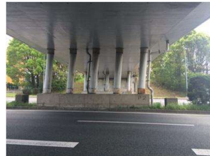
熊本ICランプ橋 橋脚柱傾斜
