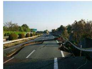
益城BS付近盛土損傷
