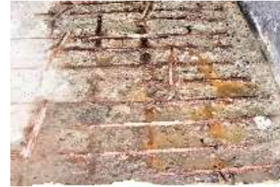
腐食、消失した鉄筋
