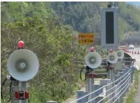
逆走検知・警告システム
