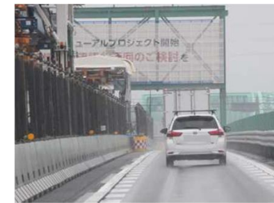
コンクリート製防護柵 による安全対策
