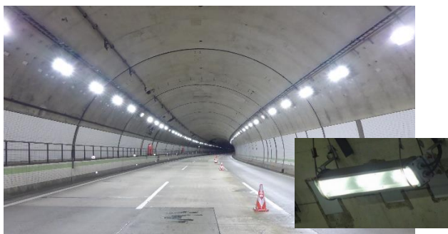
トンネル照明のLED化
