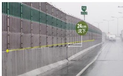
ヒンジ部沈下の状況
