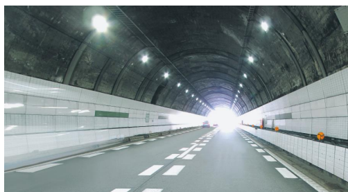
LED照明(トンネル)
