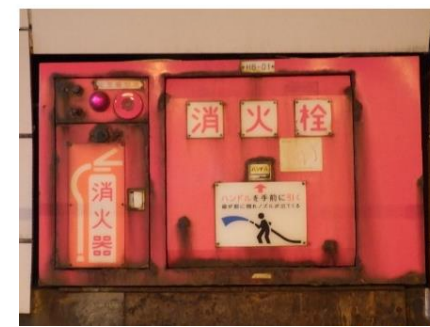
トンネル消火設備 老朽化
