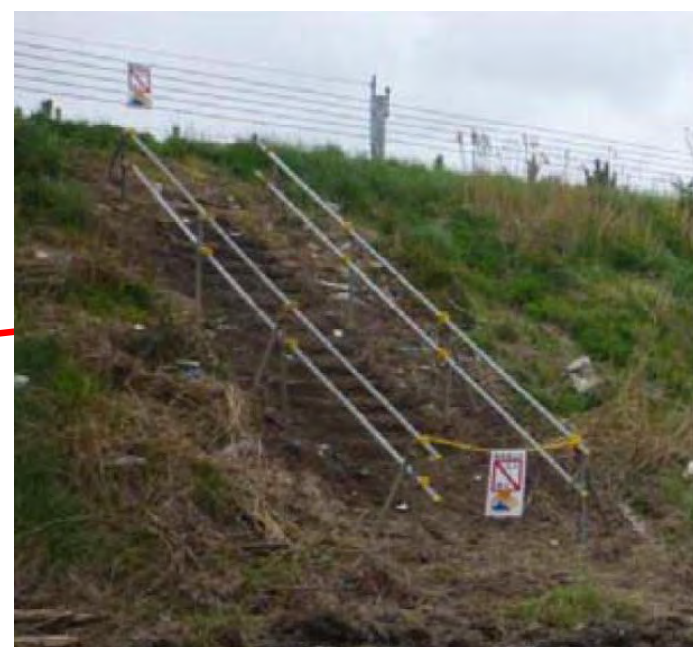
震災後、名取IC～仙台若林JCT周辺の5箇所に、津波時の避難に活用できる仮設階段を暫定的に設置(設置時期:平成23年5月)
