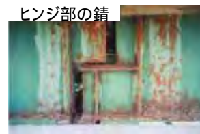
ヒンジ部の錆
