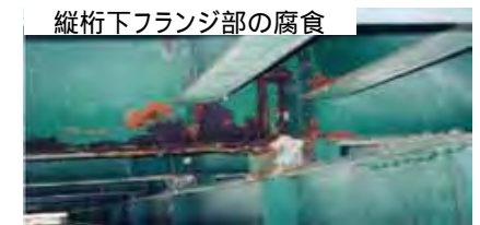
縦桁下フランジ部の腐食
