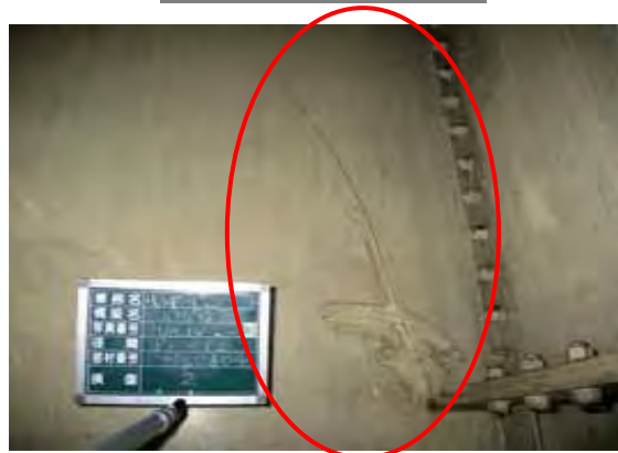
P1 - P2径間の主桁の横桁取り付け部付近の長さL = 1.1mの亀裂
