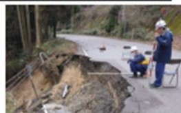
危険箇所での被災状況調査
