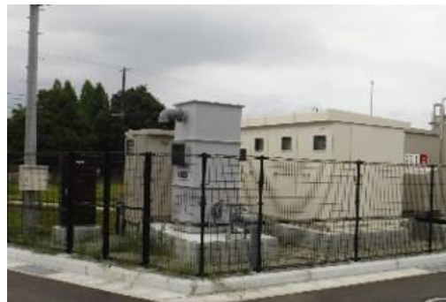
非常用電源の整備
