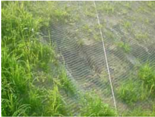
(c) のり尻部が脆弱化し、湧水等により盛土材が流失している例
