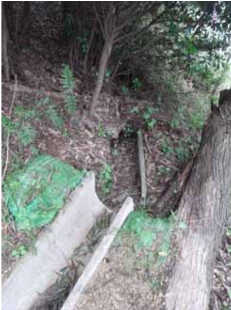
(a)排水溝のずれ
