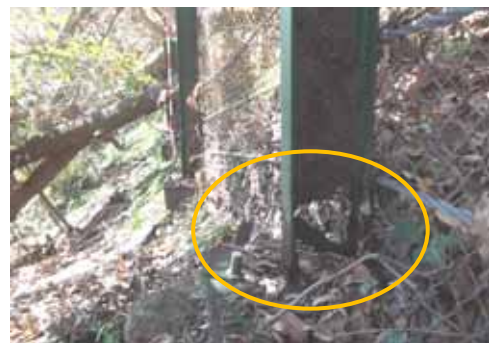
写真 - 4 . 1 4 鋼部材の著しい腐食の例(落石防護柵 H 鋼支柱基部)
