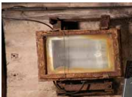
写真 - 4 . 2 3 鋼部材の著しい腐食の例（付属物：照明枠・取付部材）
