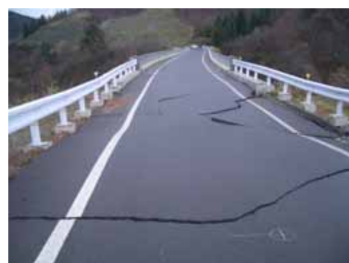
参写真 - 1 . 1 1 路面の陥没の例
