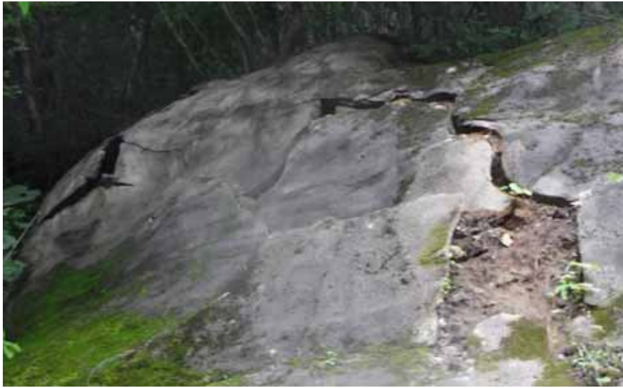
(a) 吹付工の開口亀裂、剥離、空洞および地山の露出
