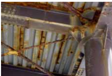
写真 - 4 . 2 1 鋼部材の著しい腐食の例（鋼製シェットの頂版斜材）
