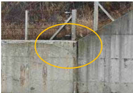
写真 - 4 . 1 3 コンクリート部材の剥離・クラックの例(落石防護擁壁)
