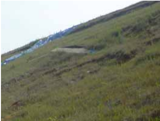
(a) のり面全体に崩壊が生じている例
