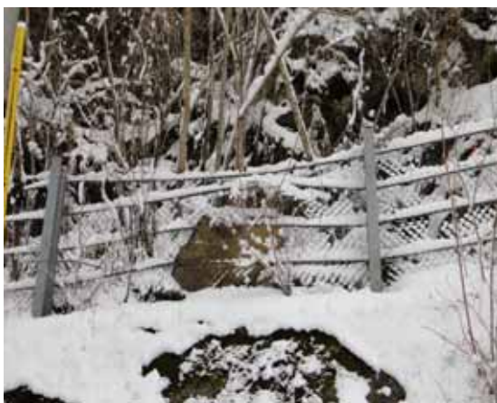
参写真 - 1 . 1 4 落石防護柵背面への土砂等(落石)堆積の例
