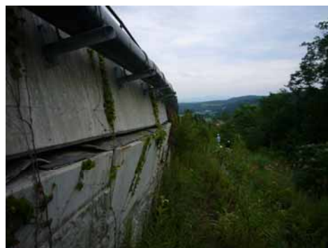
写真 - 4 . 8 防護柵基礎の傾斜の例
