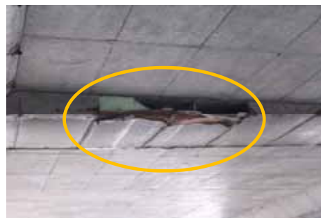
写真 - 4 . 2 4 鋼部材の腐食・破断の例（付属物：シェット漏水防止板）
