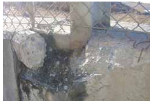
写真 - 4 . 1 2 コンクリート部材の剥離・クラックの例(落石防護擁壁)
