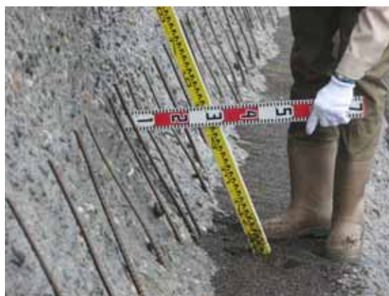
参写真 - 1 . 1 6 谷側基礎 (海岸擁壁) の変状 (摩耗・減厚による鉄筋露出) の例
