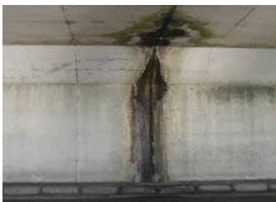
参写真 - 1 . 1 7 目地部からの漏水の例 (RC シェッド頂版・側壁)
