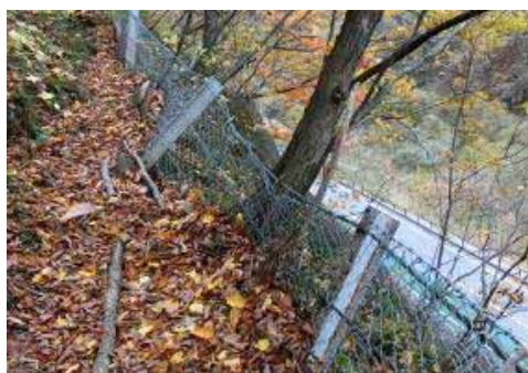
写真 - 4 . 9 部材の変形・傾動の例 ( 落石防護柵 )
