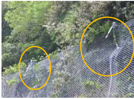
写真 - 4 . 1 1 部材の変形・傾動・鋼部材の破断の例(落石防護擁網の支柱傾動・金網変形・ワイヤロープ破断)
