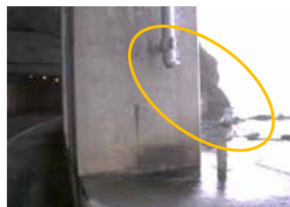
写真 - 4 . 2 6 鋼部材のゆるみ・脱落（付属物：排水管）
