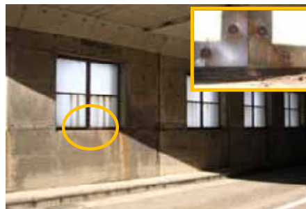
写真 - 4 . 2 2 鋼部材の著しい腐食（付属物：越波防止板取付部材）
