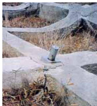
写真 - 4 . 5 受圧構造物の破損の例
