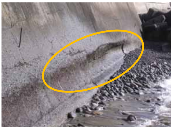
参写真 - 1 . 1 5 谷側基礎 (海岸擁壁) の変状 (摩耗・減厚) の例
