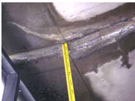
写真-4.17 部材の傾動・目地部分でのずれの例(RCシェッド頂)
