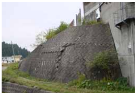
写真 - 4 . 7 壁面の割れの例
