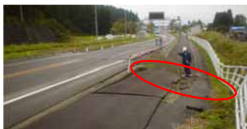
参写真 - 1 . 1 9 盛土の損傷（沈下）の例
