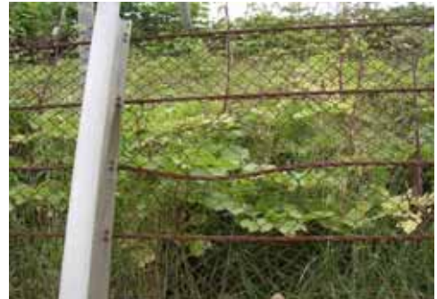
写真 - 4 . 1 6 鋼部材の著しい腐食の例(落石防護擁柵金網・ワイヤロープ)
