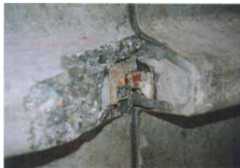
写真-4.18 コンクリート部材の剥離の例(PCシェッド頂版横桁)
