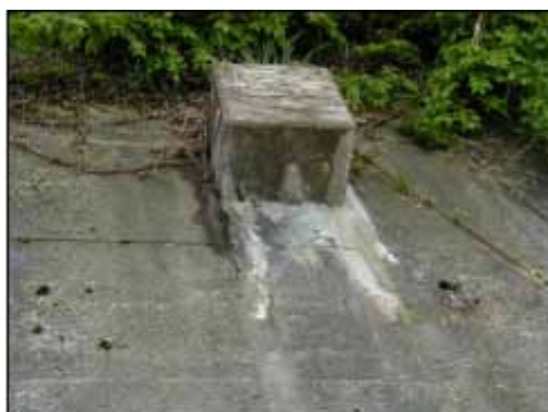
参写真-1.6 遊離石灰析出の例
