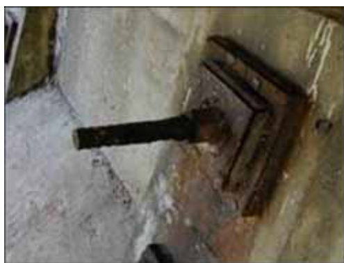
参写真-1.4 支圧板の腐食の例
