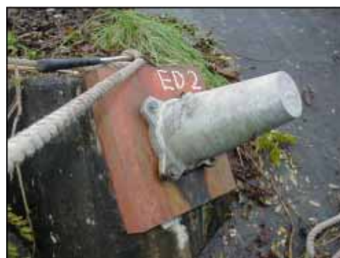
参写真-1.7 防錆油流出の例
