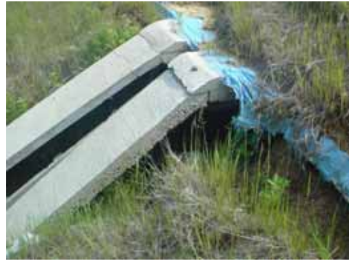
(b) 崩壊性の沈下により排水施設等の下部に空洞が生じている例
