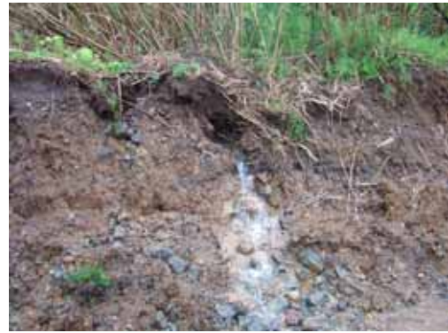
(d) のり尻部の崩壊と湧水の例
