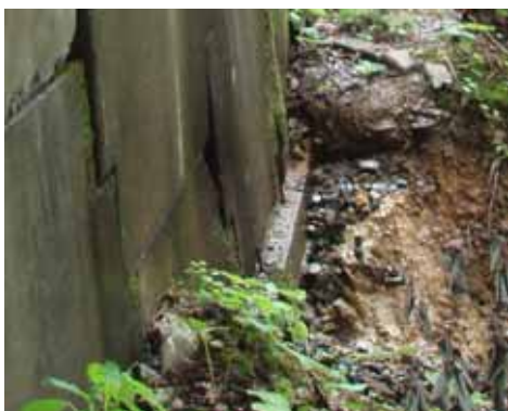
参写真 - 1 . 8 基礎地盤洗掘の例
