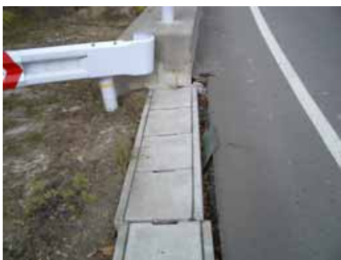
参写真 - 1 . 1 0 排水溝のずれの例
