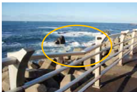
写真 - 4 . 2 5 鋼部材の破断・変形の例（付属物：防護柵横梁）
