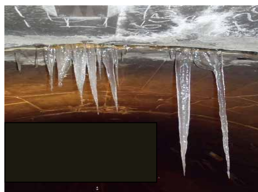
参写真 - 1 . 1 8 目地部からの漏水 (冬期のつらら) の例
