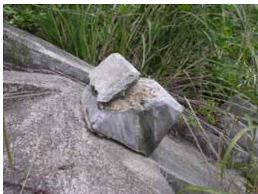
写真 - 4 . 6 頭部コンクリートの破損の例
