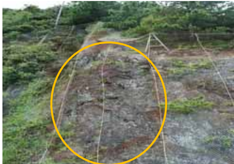
写真 - 4 . 1 5 鋼部材の著しい腐食・破断の例(落石防護擁網の金網)
