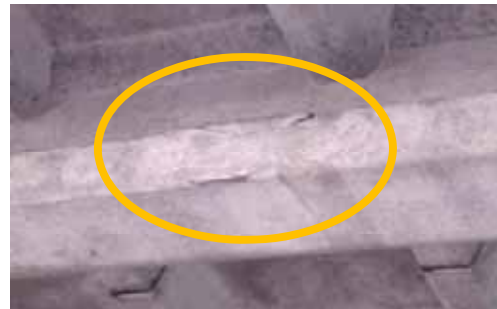
写真-4.20 コンクリート部材のクラックの例(PCシェッド頂版主桁)
