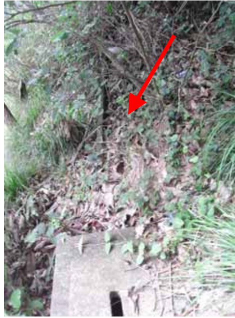
(b)排水溝の閉塞
