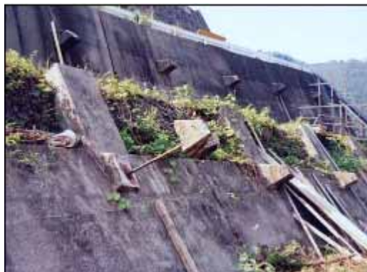
写真 - 4 . 4 アンカーの飛び出しの例
