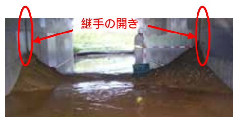
参写真 - 1 . 2 0 継手の開きおよび 水や土砂の流入
