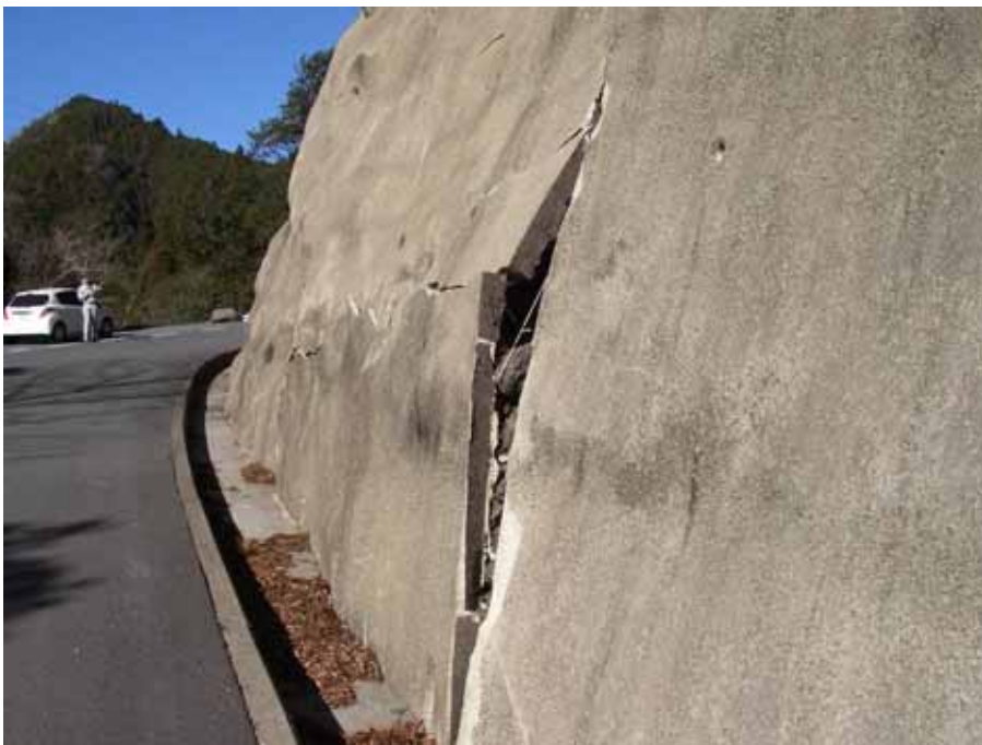
(b) 吹付のり面の目地部分でのずれおよびはらみだし
