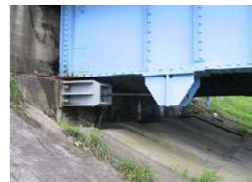
(張力が作用した状態で落橋防止が有効に機能したと推定)
