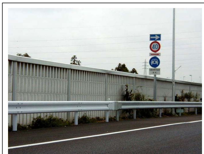
■道路管理者が異なるため、色彩の異なる防護柵が連続して設置された例
