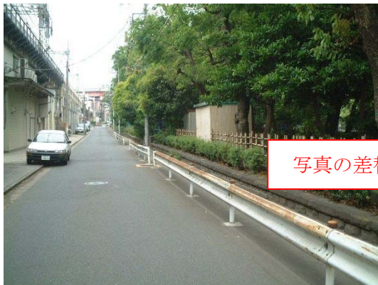
■錆びが目立ち始めている防護柵の例 適切な修繕・更新を行っていくことが求められる
