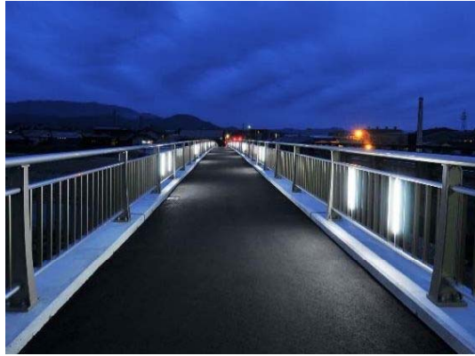
■高欄の縦棧内蔵照明 ポール照明の管理の手間を軽減するとともに、新しい灯りの姿を実現
