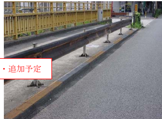
■防護柵全体が錆びつき、汚らしい印象となっている
