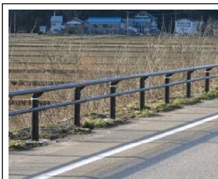
■防護柵の支柱に反射シートを巻き付けることにより、視線誘導を確保している例
