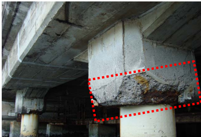
コンクリートの剥落
