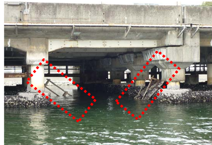
点検通路の欠損
