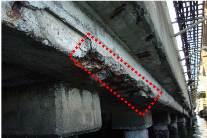
コンクリートの剥落
