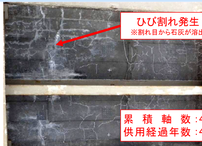
RC床版のひび割れ
