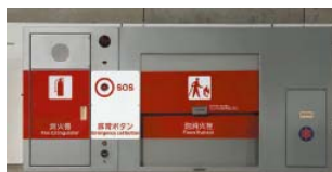
消火器・泡消火栓
