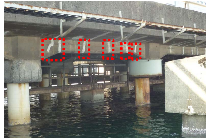
ひび割れの補修跡
