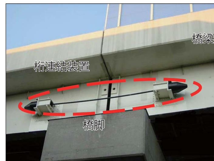
■ 橋桁をケーブルで連結し、落下防止 ■
