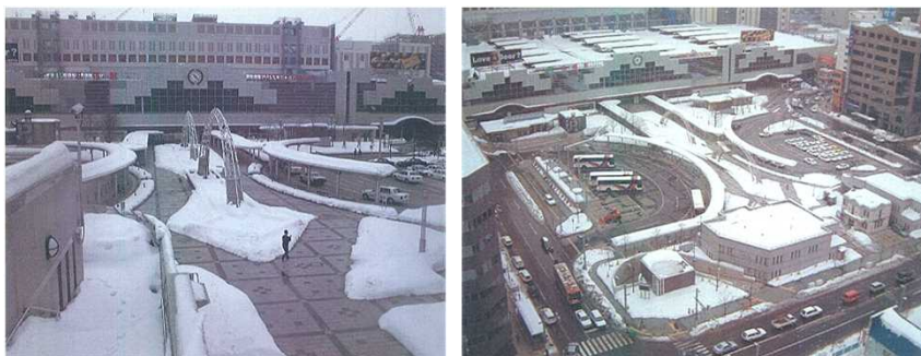
動線上に設置されたロードヒーティング（札幌駅北口広場）
