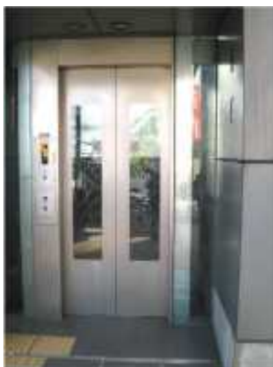
写真 2-2-3 乗降口の操作盤設置例
