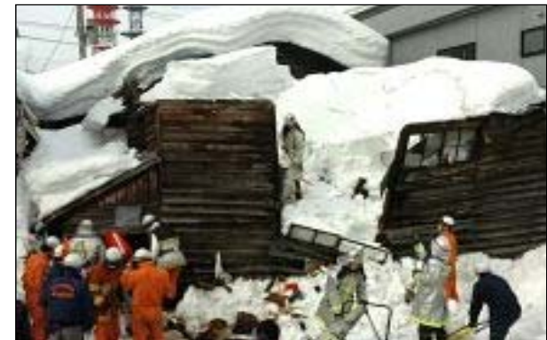
○ 雪の重みで倒壊した家屋
