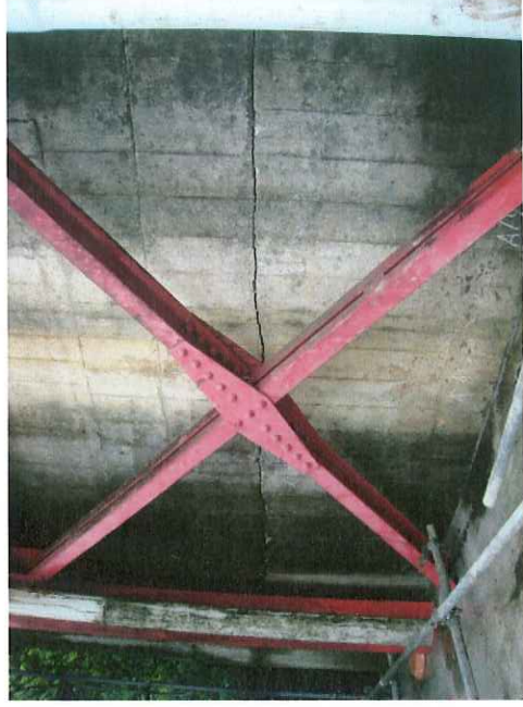
橋台の横断クラック
