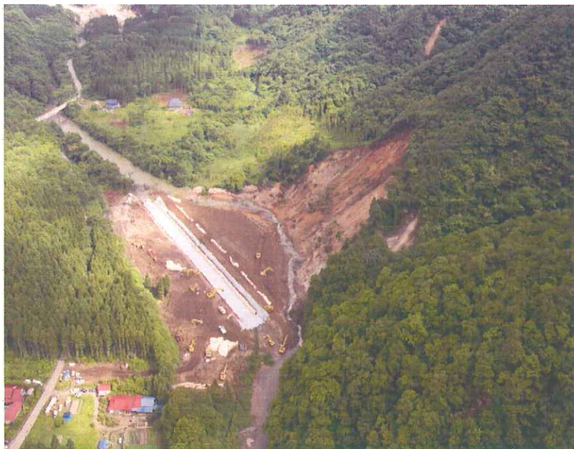
崩壊全景 国土交通省による河道閉塞緊急対策工事の様子 (花山字本沢浅布地内)
