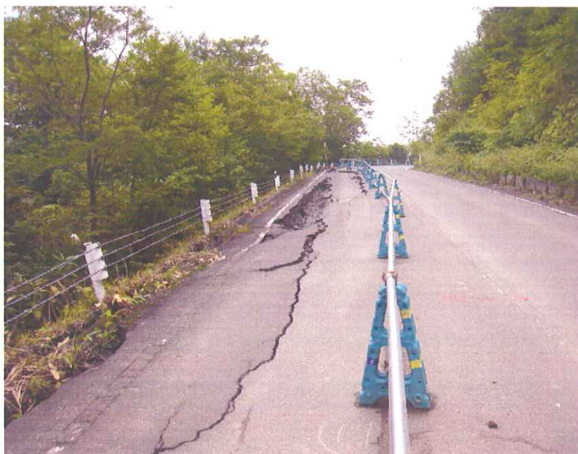
山間区間の路肩崩壊状況 (花山温湯～湯浜峠区間)
