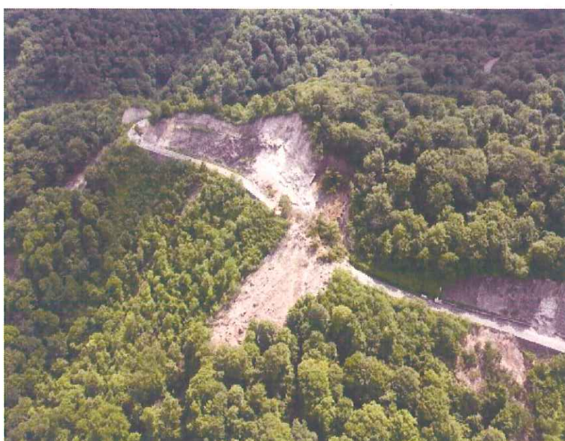
山間区間の法面・国道398号崩壊状況 (花山温湯～県境方面 湯浜地区)
