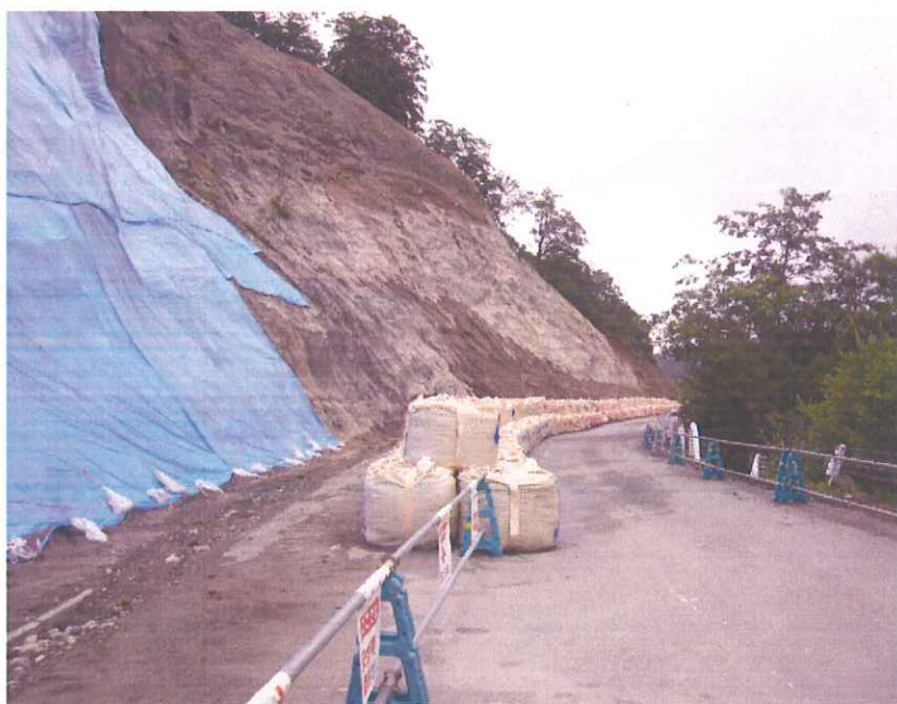
山間区間の法面崩壊状況 (花山温湯～県境方面 湯浜地区)
