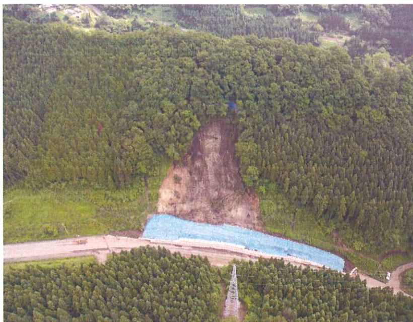
法面崩落全景
