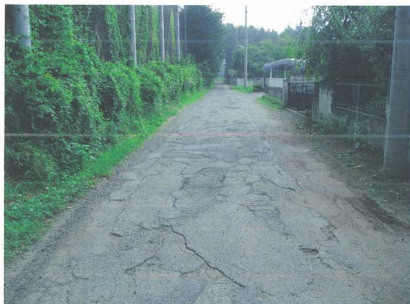
(道路舗装面が凸凹な状況)
