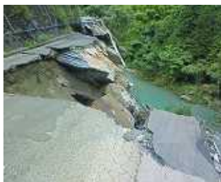
唯一の生活道路が崩壊(国道)
