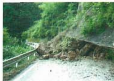
大雨の影響による土砂崩れ 県道安田東洋線（安田町）
