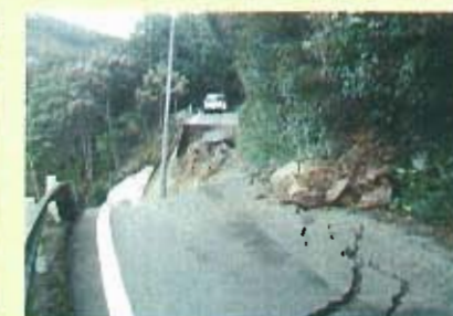
台風による道路崩壊 県道土佐清水宿毛線（土佐清水市）
