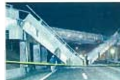
アメリカで建設45年後の橋がコンクリート析の鉄筋腐食により落橋
