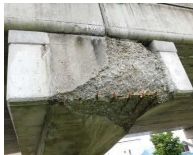
下部工の剥離鉄筋露出
