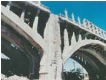
補修前（架設後約70年）
