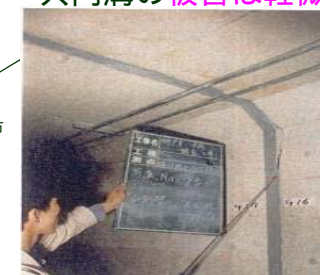
写真・神戸市内の共同溝の状況
