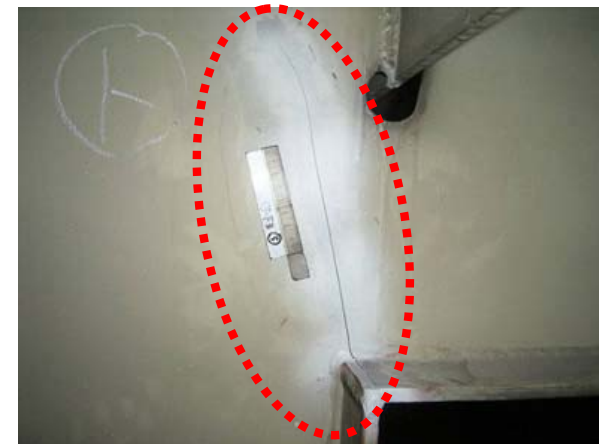
【箱桁部材に発生したき裂】
