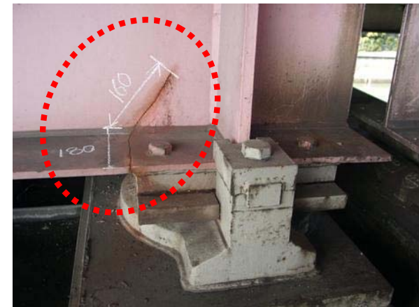
【桁端部に発生したき裂】
