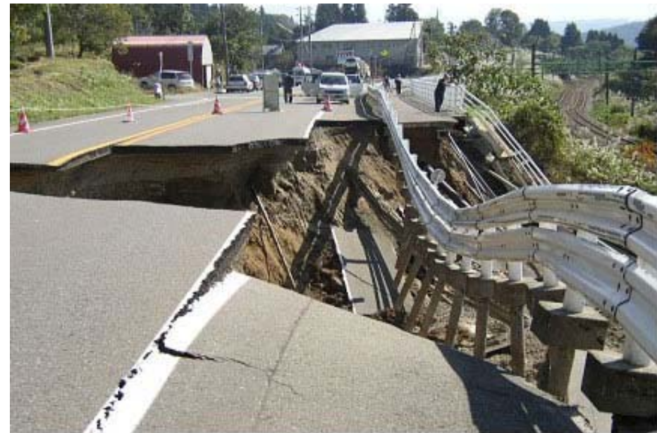
国道17号の崩壊（新潟県川口町）
