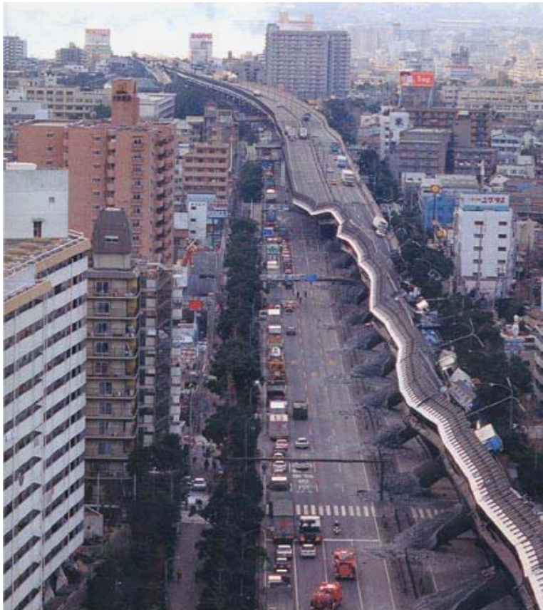
阪神高速の高架橋が並行する国道43号上に倒壊
