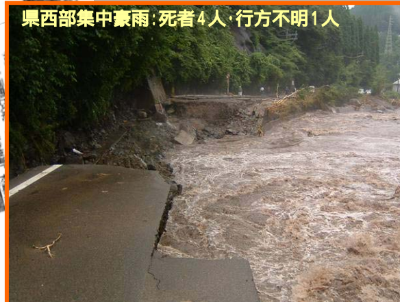
平成17年7月 県西部集中豪雨 玖珠郡九重町 県道 飯田高原中村線
