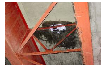
床版損傷事例 S45建設の橋(供用後34年)
