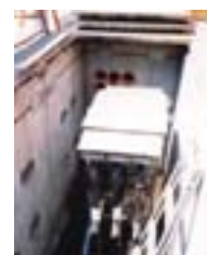
地下設置型トランス
