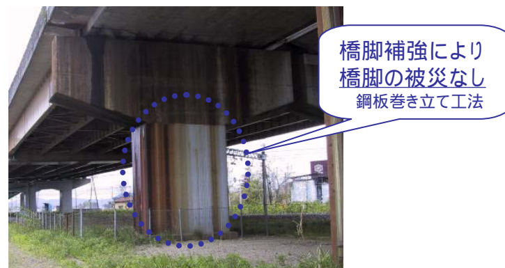
新潟県中越地震(震度7) / 長岡市十日町
