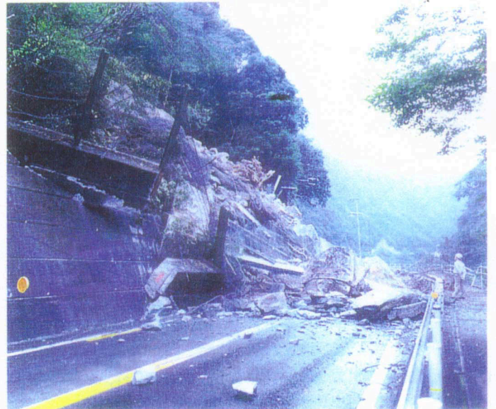
法面崩壊による規制(国道32号・徳島県山城町)
