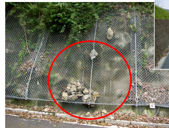
落石状況（対策後） 落石防止効果あり
