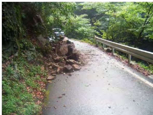
落石状況（対策前）
