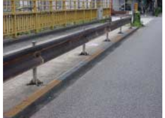
防護柵全体が錆びつき、汚らしい印象と なっている
