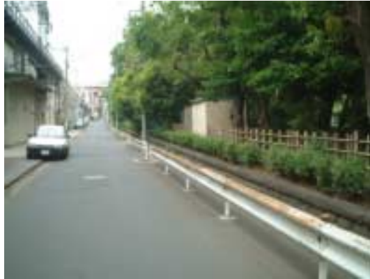
錆びが目立ちはじめている防護柵の例 適切な修繕・更新を行っていくことが 求められる
