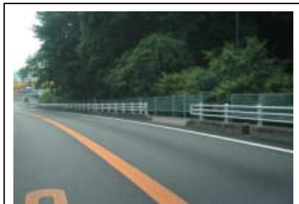
車両用防護柵(歩車道境界)と転落防止柵(歩道路側)の色彩が異なり、景観的な調和が感じられない
