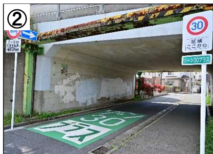
ゾーン30プラス看板・路面表示 車両通行禁止規制(7-8:30・土日除く)
