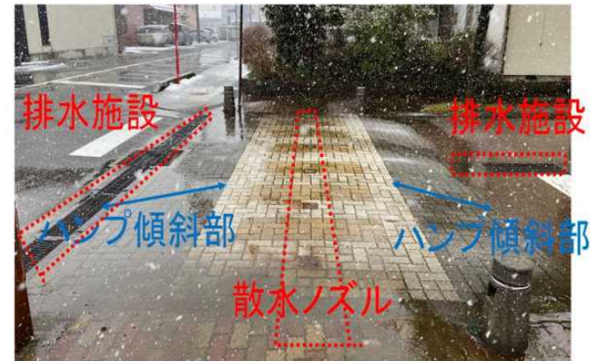
消雪パイプを設置したハンプ
