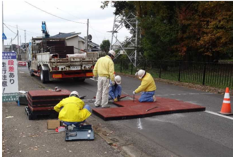
国総研の可搬型ハンプを使用した設置事例(社会実験)
