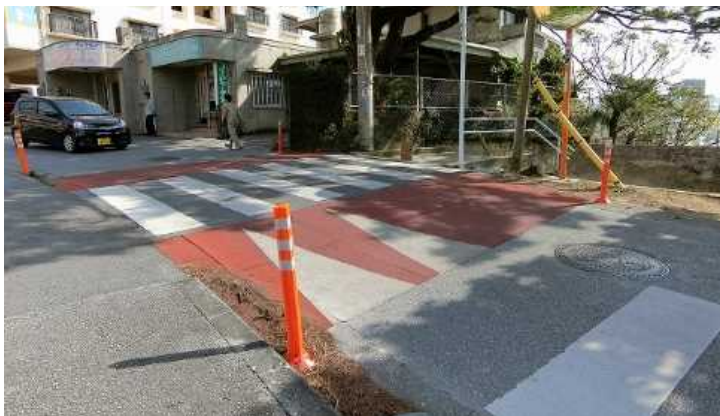
出典：国土技術政策総合研究所資料No.1088「生活道路におけるハンプ・狭さくの設置事例集2019」
