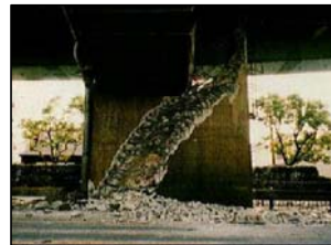
橋梁の被災(兵庫県南部地震)
