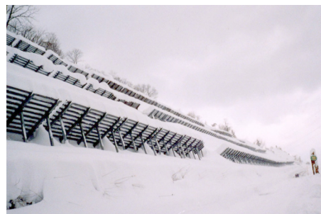
【雪崩予防柵による雪崩対策】
