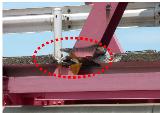
トラス橋の斜材の破断
