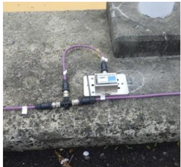
3軸加速度計の設置例 (拡大)
